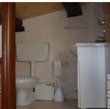
Confort interior e instalaciones
